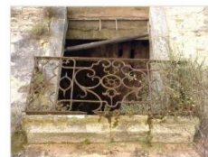
VÃO EM FALTA
