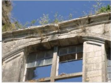
PEDRA DE FECHO EM RISCO DE RUÍR
