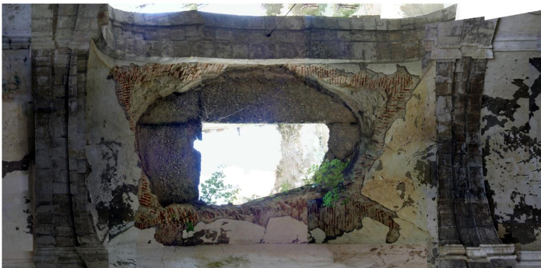
INTERVENÇÃO INCORRECTA COM LAJE DE BETÃO; COLAPSO DA ABÓBADA
