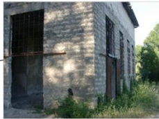
VÃOS EM FALTA
