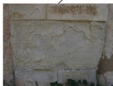
PEDRA DESAGREGADA (DESCAMAÇÃO)
