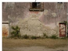
DESAGREGAÇÃO DO REBOCO
