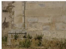
PRESEÇA DE LÍQUENES; DESAGRAÇÃO DA PEDRA (DESCAMAÇÃO)
