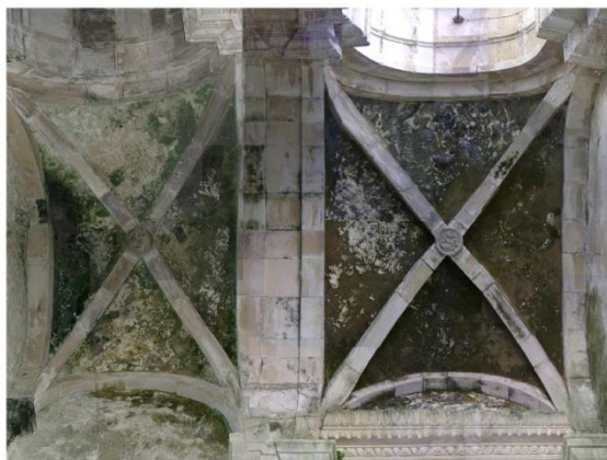
MANCHAS DE HUMIDADE; PRESENÇA ORGÂNICA
